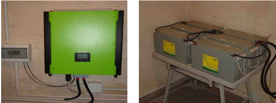
Rys. 2. Falownik i bateria akumulatorów
