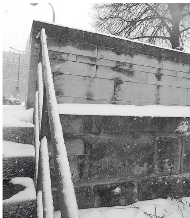
Mur oporowy zwiększający ochronę przeciwpowodziową wzdłuż rzeki Łaby w Dreźnie. Część górna dobudowana po wydarzeniach z 2002 roku
