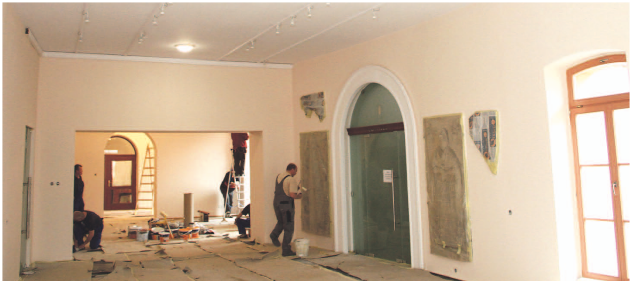
Pomieszczenia przyszłego muzeum Uniwersytetu Opolskiego na miesiąc przed otwarciem (fot. Jarosław Mokrzycki)
