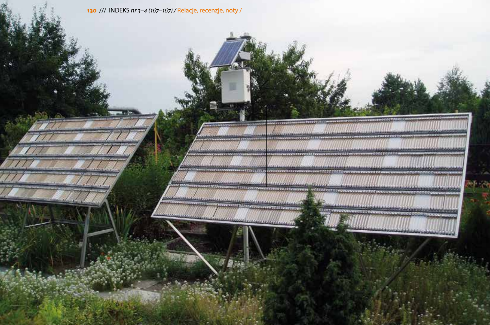
Stacja poligonowa w przydomowym ogródku prof. Krystyny Czai
