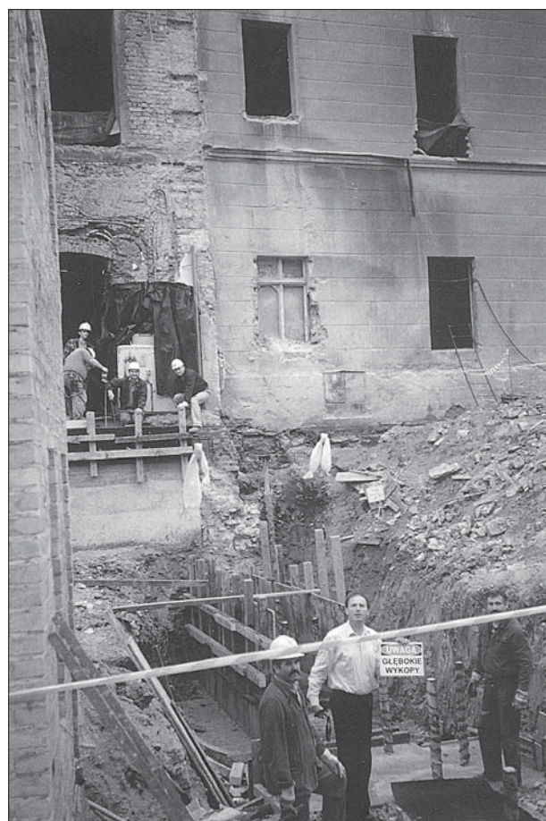
Fundamenty budynku wymagały wzmocnienia
