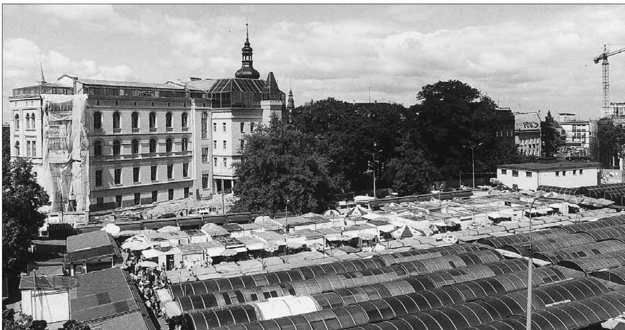
Rok 2001. Trwa budowa Collegium Maius UO. Na pierwszym planie – targowisko „Cytrusek”. Fot. Tadeusz Parcej
